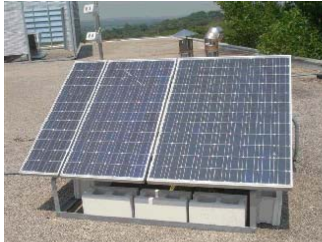
Fig. 6: Sistema fotovoltaico (3 paneles). ETSII de la UNED
