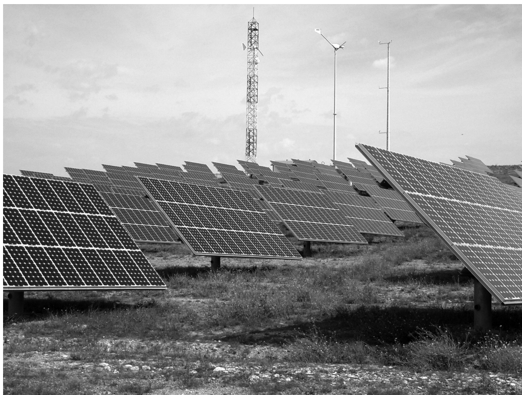
Figura 1.19. Paneles de la Central Fotovoltaica de Tudela, Navarra (por cortesía del prof. M. Castro).
